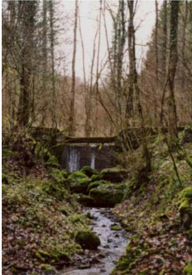
Abbildung 61: Einer Sperre vorgelagerte Blöcke als Kolkenschutz (Geschiebesammler 3.09).
