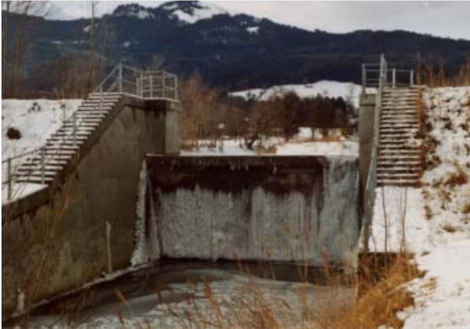
Abbildung 46: Massives Abschlussbauwerk des Geschiebesammlers am Dürrenbach bei Eichberg.
